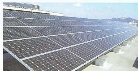
太陽光発電システム
