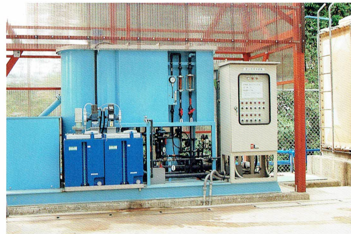
汚水処理装置
