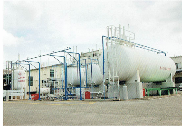
LPガス貯槽
