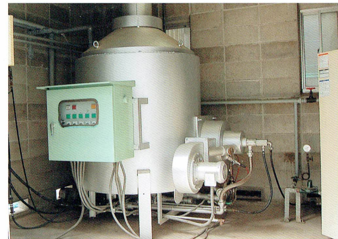
残ガス臭気燃焼炉
